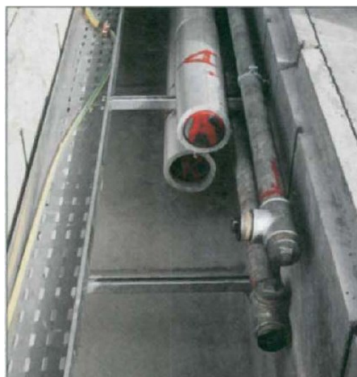
TUBAZIONI ALL'INTERNO DI UN CUNICOLO TECNOLOGICO
