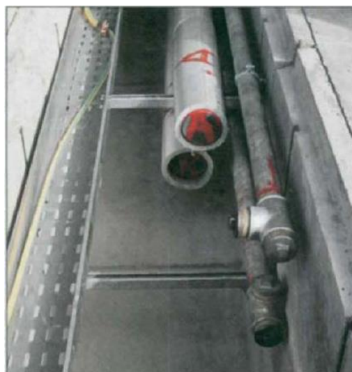
TUBAZIONI ALL'INTERNO DI UN CUNICOLO TECNOLOGICO
